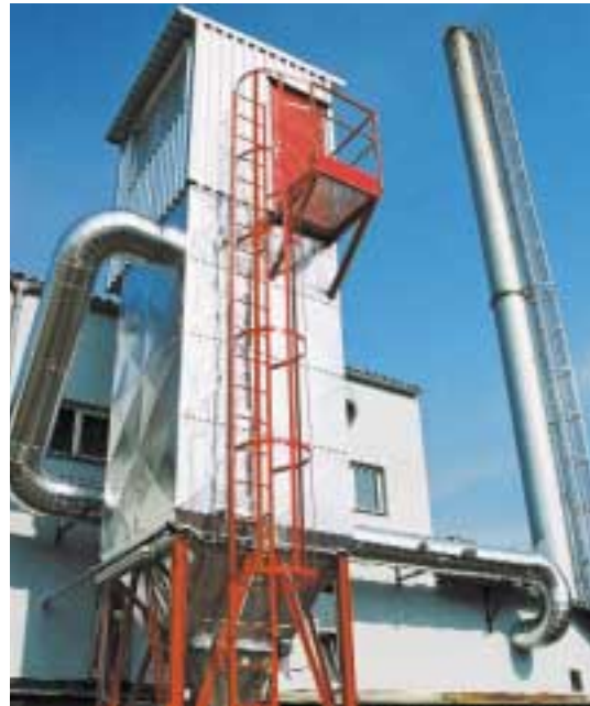
Gesamtansicht der NEUTREC ® -Anlage. Foto: S.M.S. CZ, s.r.o.
